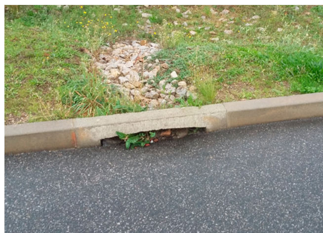
Bouche d'alimentation avec empierrement permettant de diriger les eaux pluviales d'un parking vers la noue (Saint-Just-Saint-Rambert [42]). / Robin Dagois, Plante & Cité
