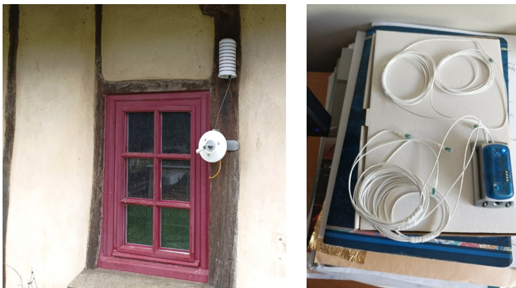
Figure 59 : Installation d'un pyranomètre et de l'abri météorologique pour le capteur T & HR (image à gauche) et d'un Data logger MSR avec sondes (image à droite)
