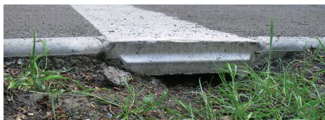
Figure 55 : Lombriduc installé à Lille sous un chemin stabilisé © F. Lamiot, CC BY-SA
