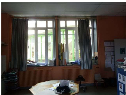
Exemple d'une menuiserie encombrée classe des maternelles au RDC
