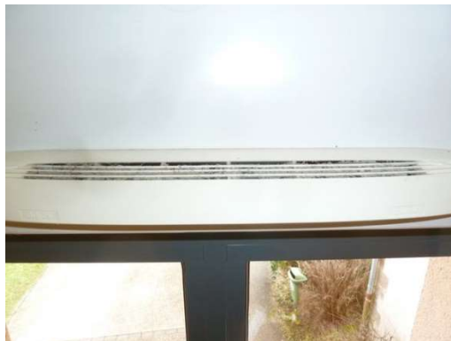
Exemple d'entrée d'air encrassée école primaire
