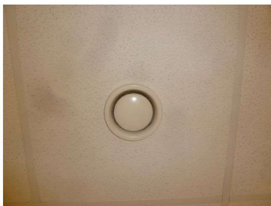
Exemple de bouche d'extraction salle de propreté
