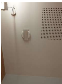
Bouches d'insufflation dans une salle de classe
