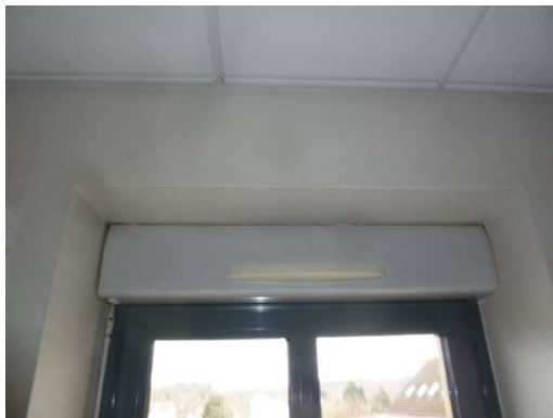
Exemple d'entrée d'air école primaire
