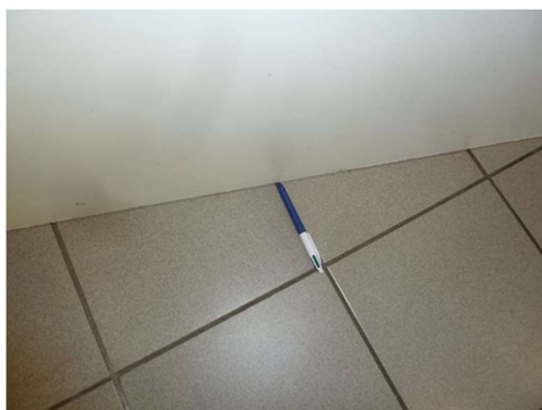
Exemple de détalonnage non conforme
