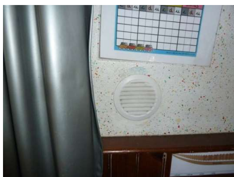
Vue depuis la salle de classe de la grille d'aération naturelle
