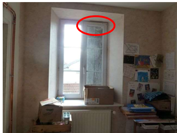
Menuiserie avec entrée d'air - bureau de la directrice
