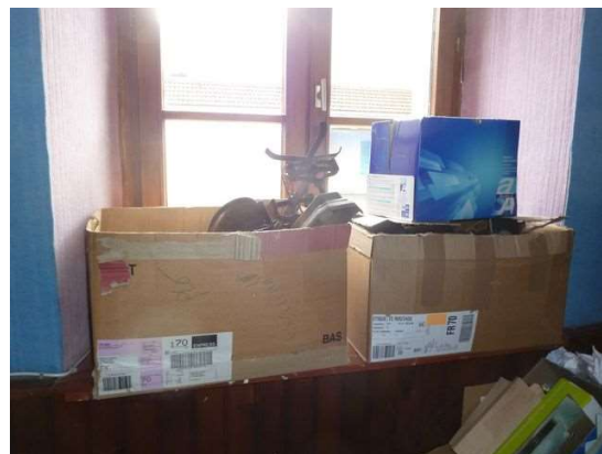
Exemple d'une menuiserie encombrée salle BCD au RDC
