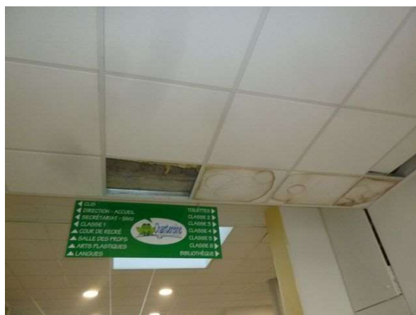
Vue du plancher haut du hall avec dalles de sous-plafond absente
