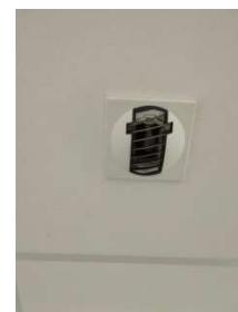
Bouche d'extraction dans les sanitaires
