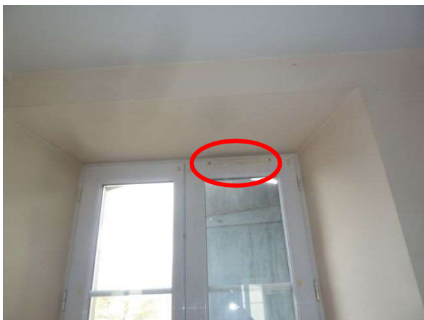
Menuiserie avec entrée d'air cassée - « classe supp »
