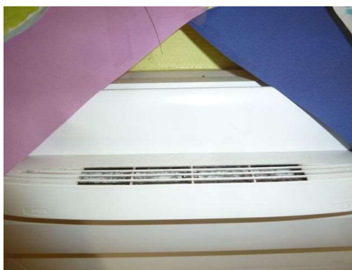
Exemple d'entrée d'air encrassée
