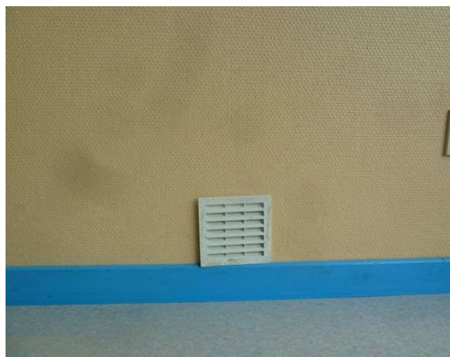
Vue zoomée sur une grille d'aération naturelle
