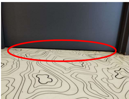
Exemple d'un détalonnage de porte non conforme (bureau de la direction)
