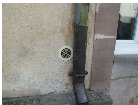
Vue depuis l'extérieur de la grille d'aération naturelle
