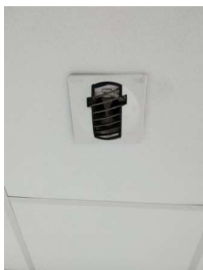
Exemple de bouche d'extraction sanitaire
