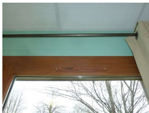
Exemple d'entrée d'air de la marque Nicoll cassée
