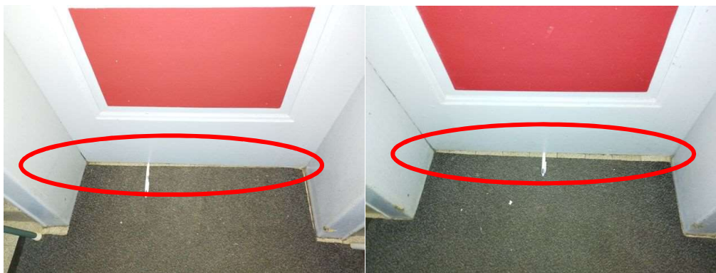
Exemple d'un détalonnage de porte non conforme (photo de gauche) et conforme (photo de droite)
