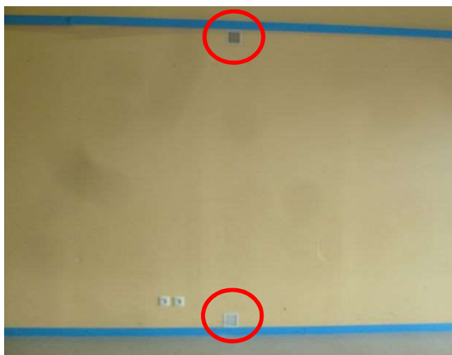
Exemple de grilles d'aération hautes et basses
