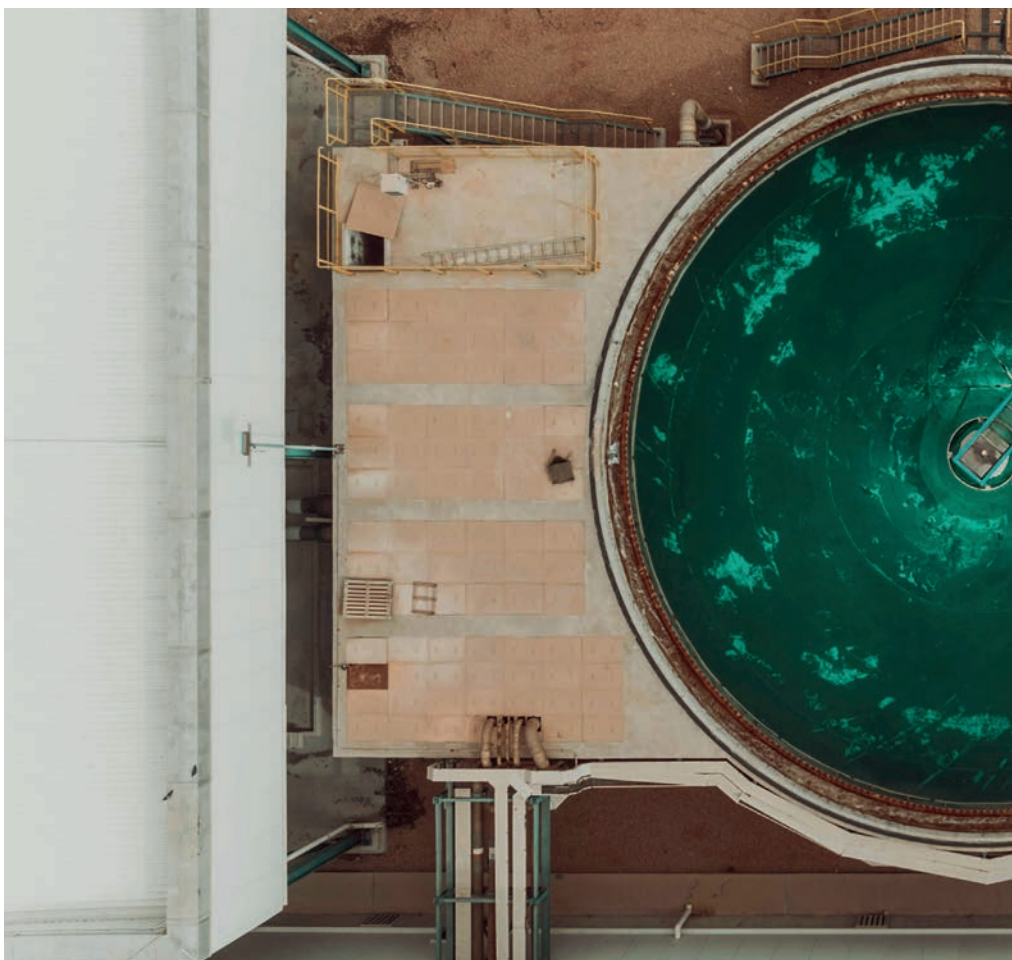
Station d'épuration © Libre de droits
