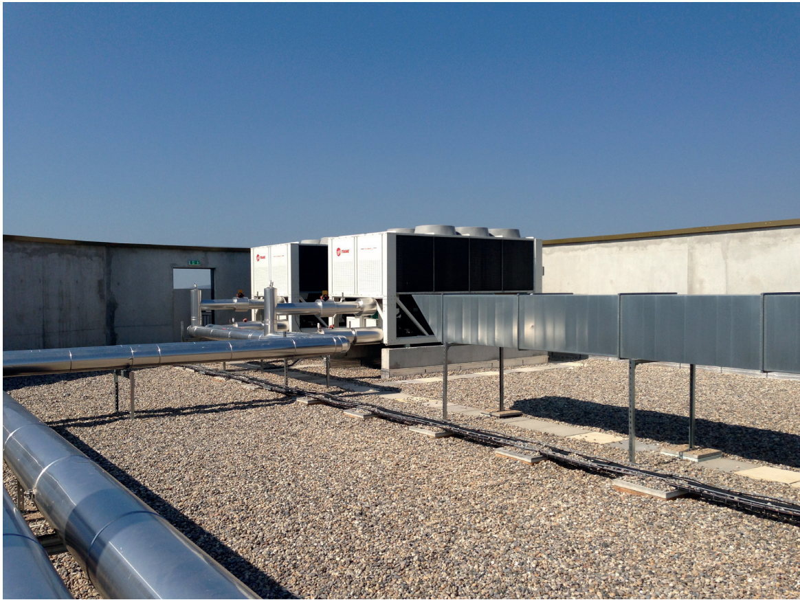
Unité extérieure d'une pompe à chaleur (photo : Cerema)
