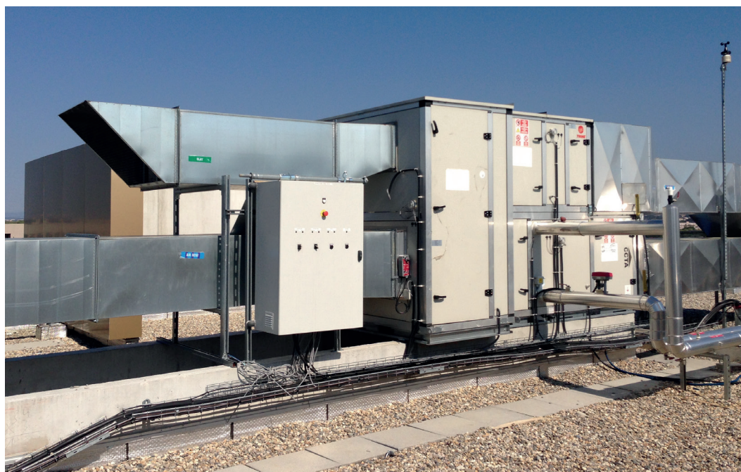
Centrale de traitement d'air (photo : Cerema)
